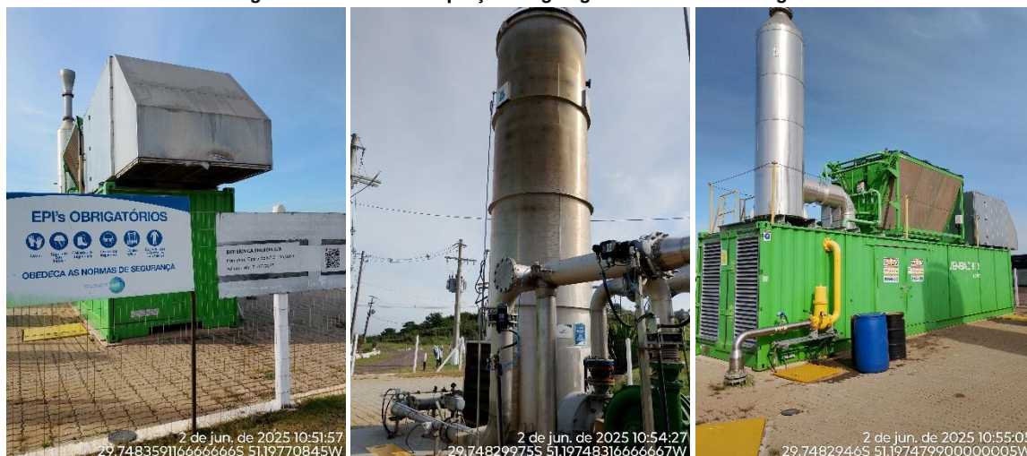
Figura 9: Sistema de captação de gás gerado e usina de biogás
