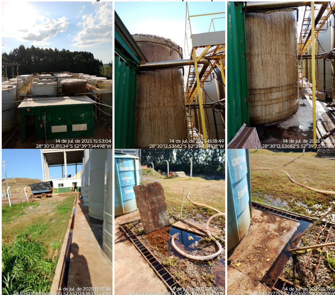
Figura 11: Materiais de obra espalhados pela unidade
