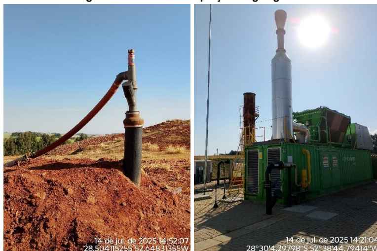
Figura 12: Sistema de captação de gás gerado
