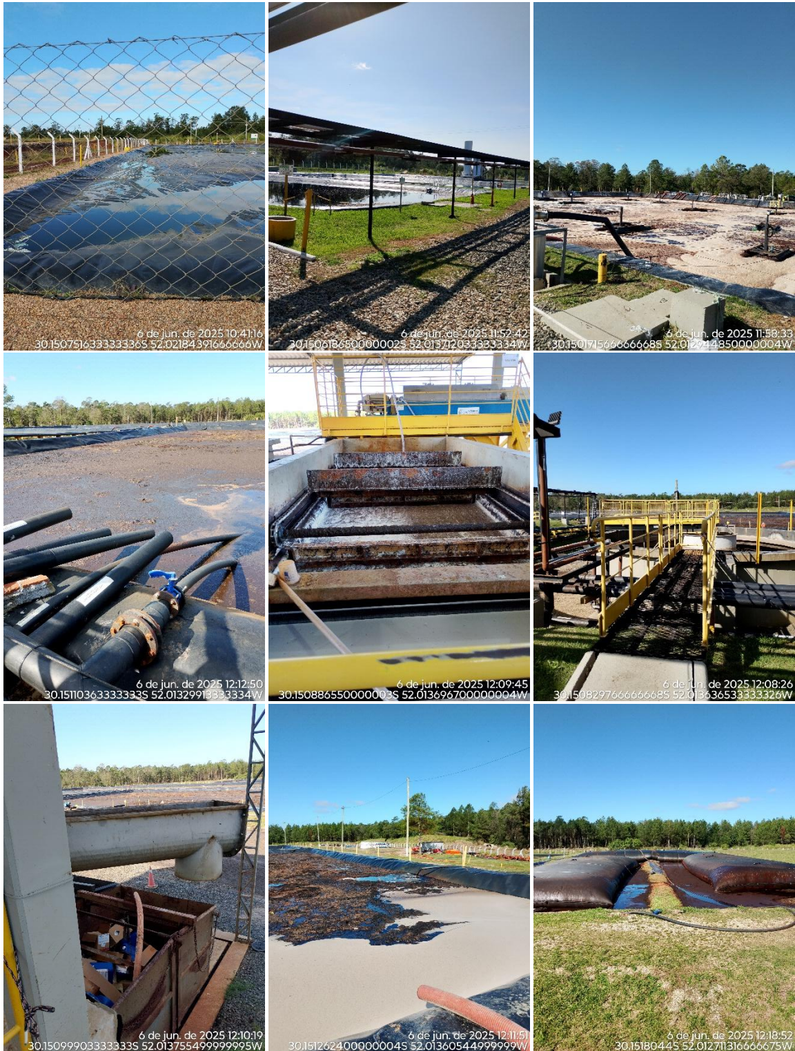
Figura 7: Estação de Tratamento de Efluentes
