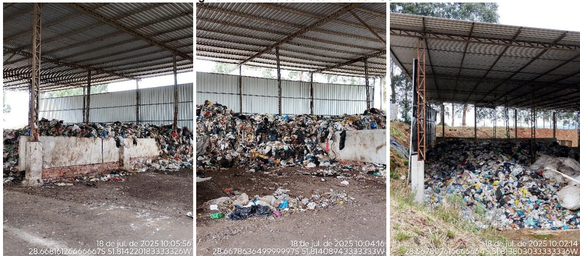
Figura 4: Pavilhão com acúmulo de RSU
