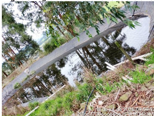
Figura 6: Lagoa de armazenamento de chorume
