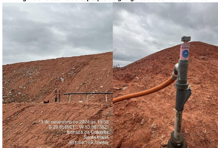
Figura 9: Sistema de captação de gás gerado e usina biotérmica
