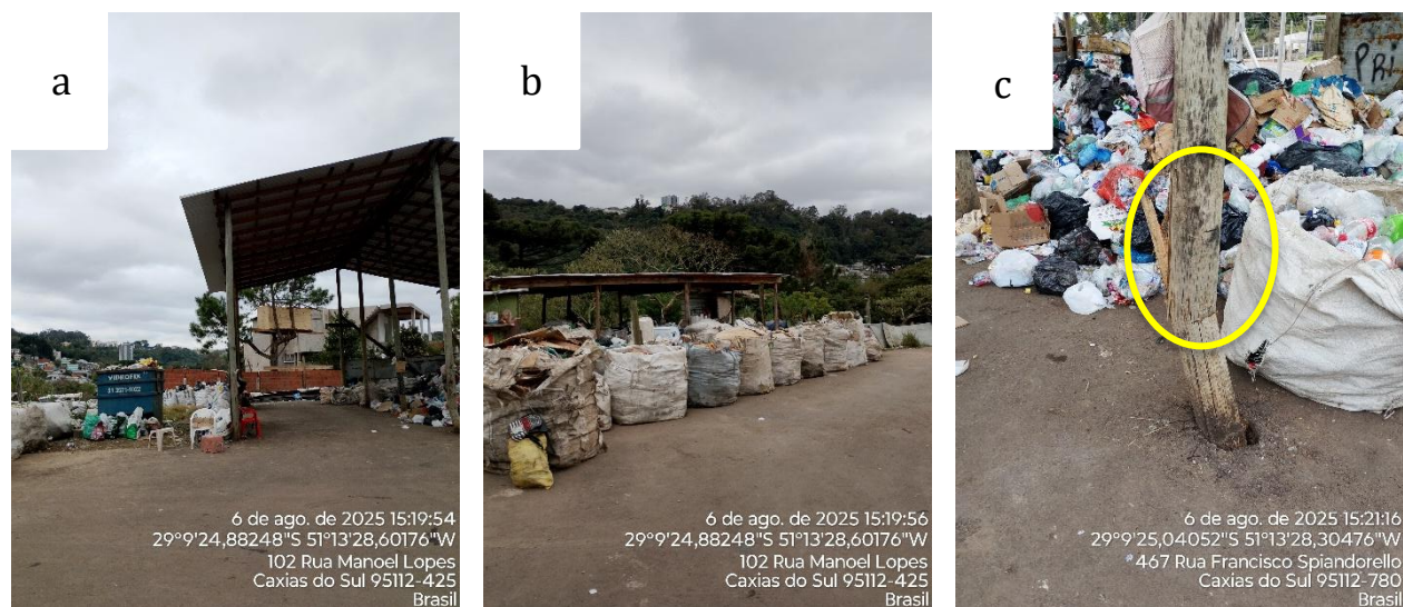
Figura 11: Central de Triagem União dos Catadores. a) Visão geral do galpão de triagem; b) Visão geral do armazenamento de resíduos reciclados e c) Estrutura danificada do galpão de triagem.
