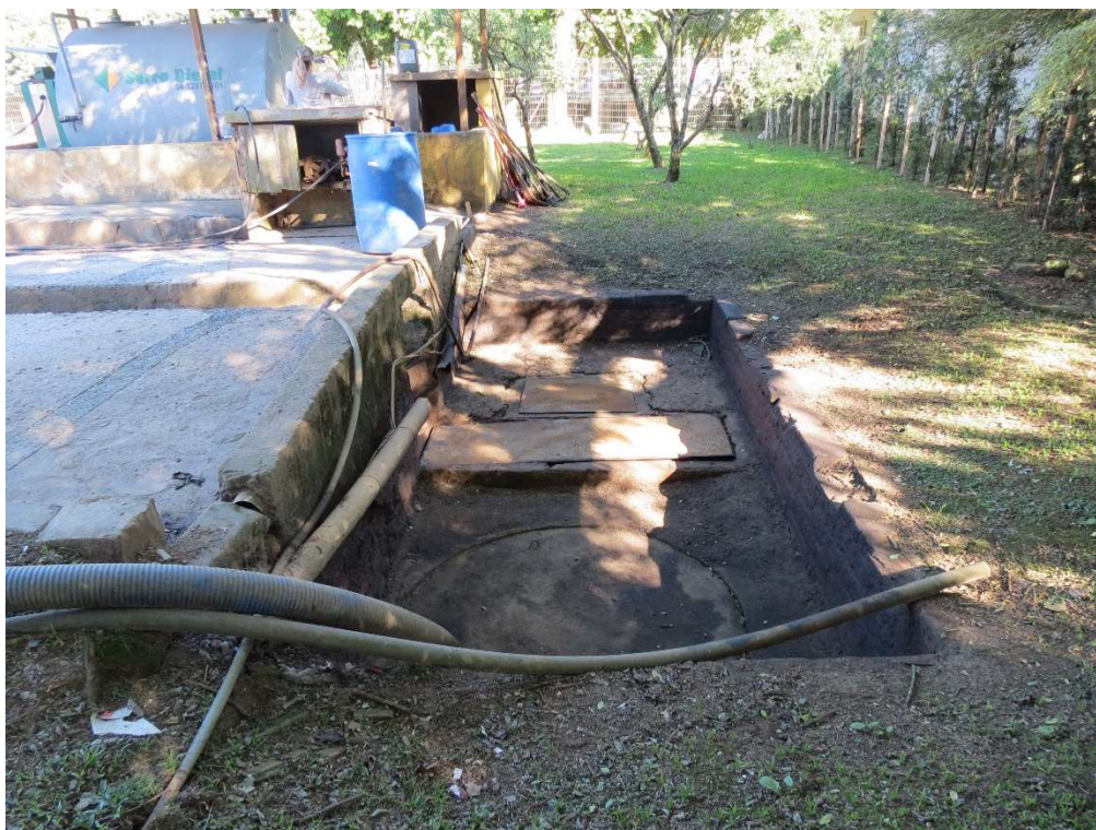
Figura 18: Caixa separadora de água e óleo.
