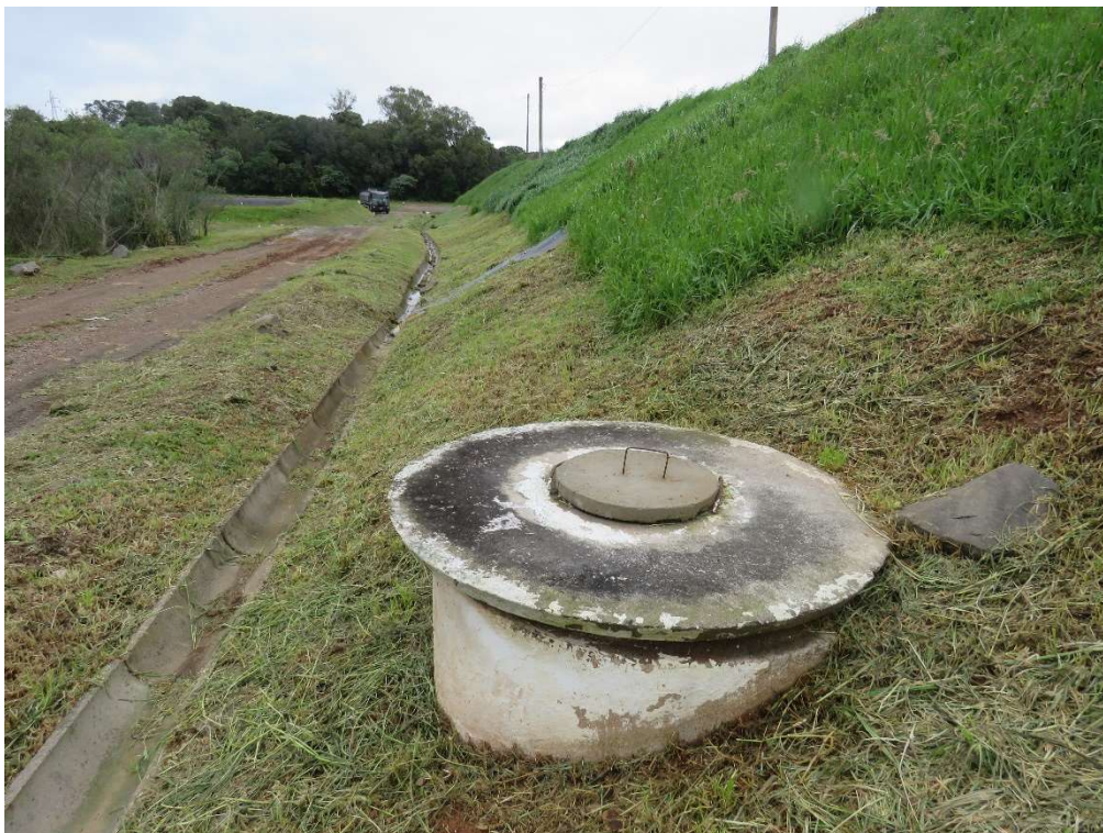
Figura 2: Dreno testemunho de monitoramento.
