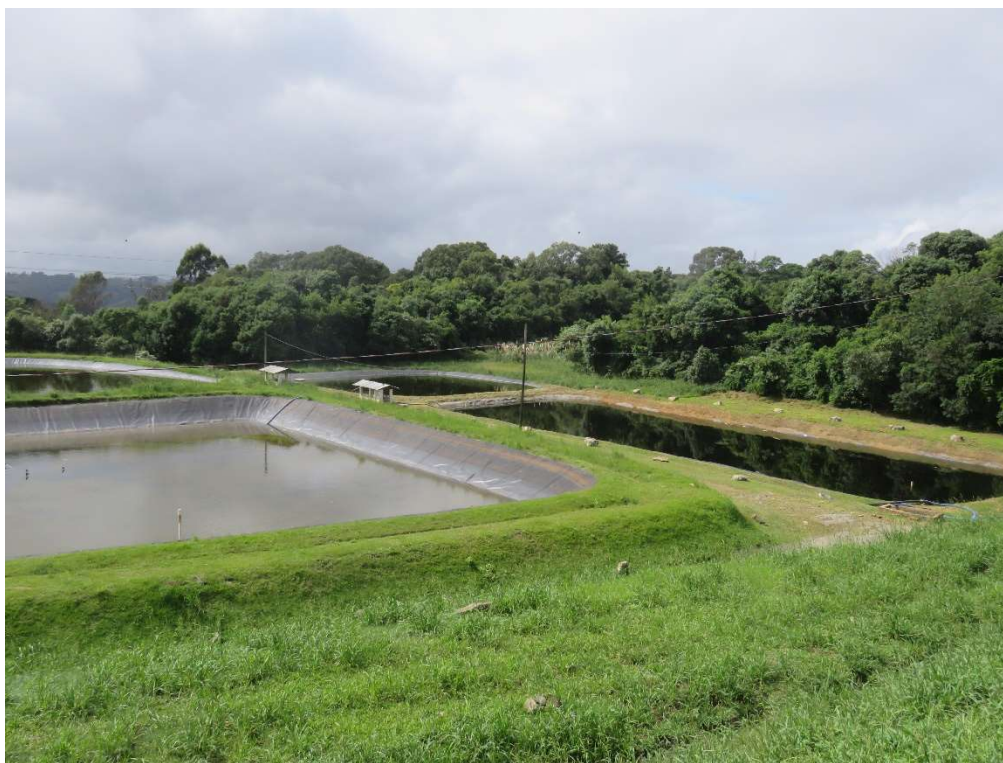
Figura 22: Lagoas de tratamento de efluente.
