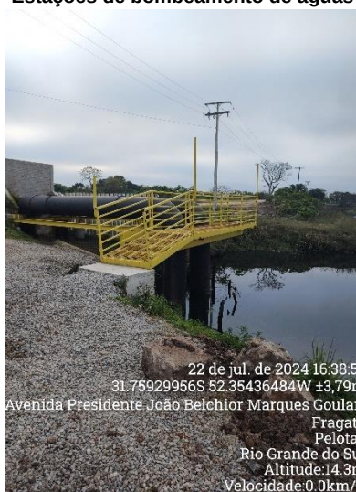
Estação de bombeamento - Castilhos
