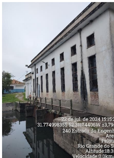
Estação de bombeamento - Leste
