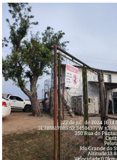
Estação de bombeamento - Zona Sul - Olvebra
