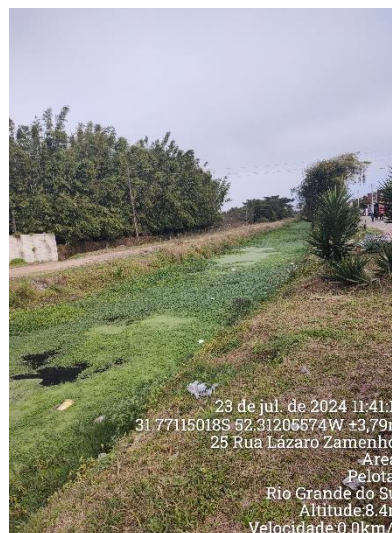
Canal da Casa de Bombas – Av. Cidade Rio Grande
