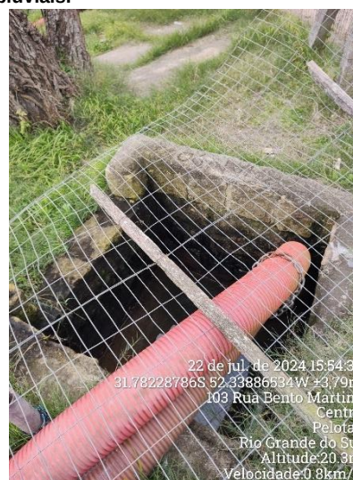
Estação de bombeamento - Doquinhas
