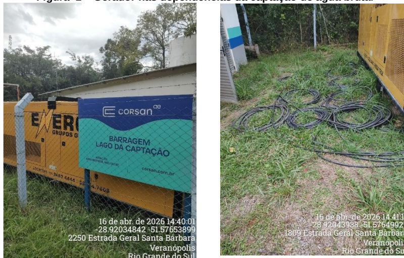
Figura 1 – Gerador nas dependências da captação de água bruta.
