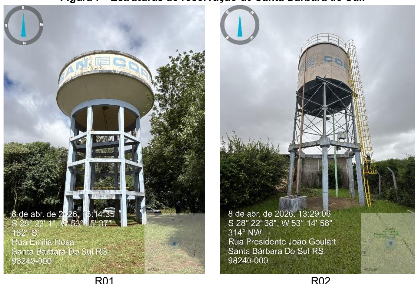
Figura 7 - Estruturas de reservação de Santa Bárbara do Sul.
