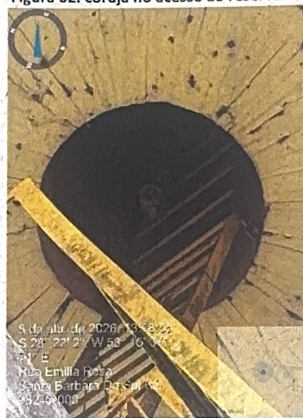
Figura 02: coruja no acesso ao reservatório
