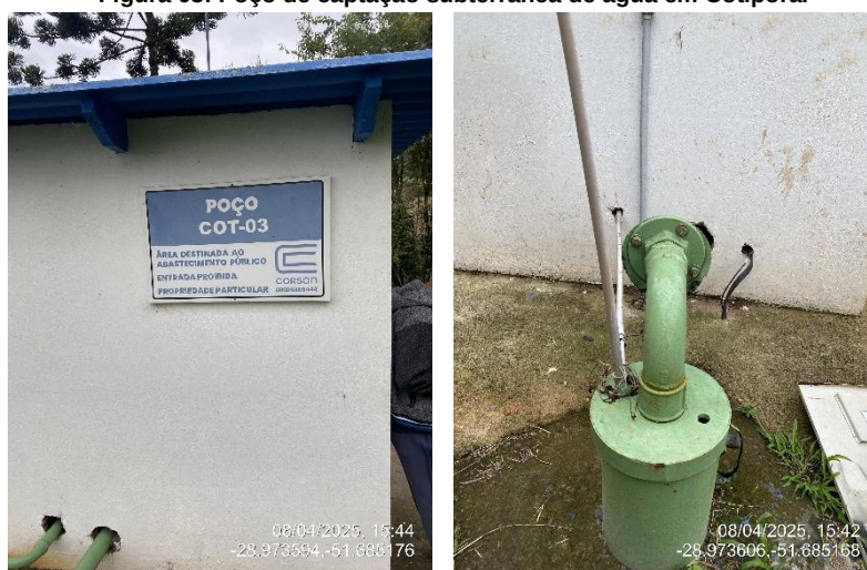
Figura 03: Poço de captação subterrânea de água em Cotiporã.
