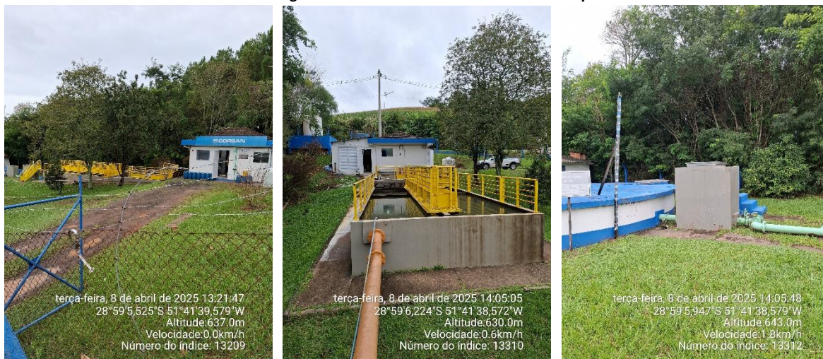
Figura 05: Bloco hidráulico da ETA de Cotiporã
