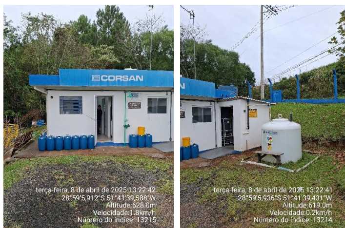
Figura 06: Laboratório operacional e área do equipamento gerador de hipoclorito de sódio.
