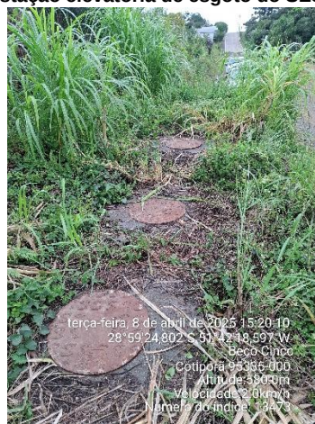
Figura 08: Estação elevatória de esgoto do SES de Cotiporã.
