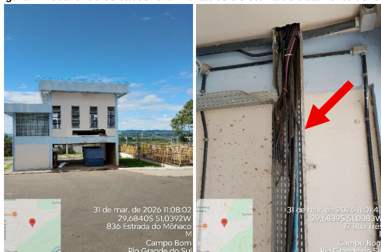
Figura 2: Local onde os cabos foram furtados e sistema de tratamento de lodo
