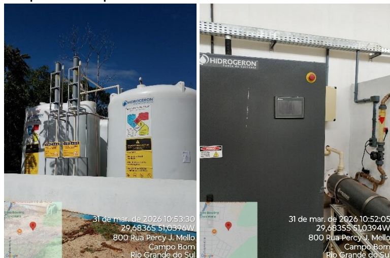
Figura 3: Equipamento produtor de hipoclorito de sódio e reservatórios de armazenamento do produto químico.
