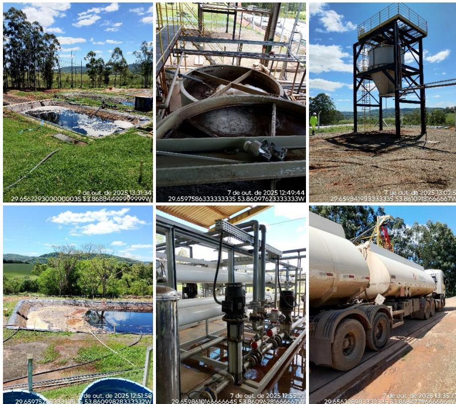
Figura 8: Estação de tratamento de efluentes da CRVR unidade de Santa Maria
