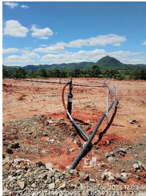
Figura 9: Sistema de captação de biogás gerado
