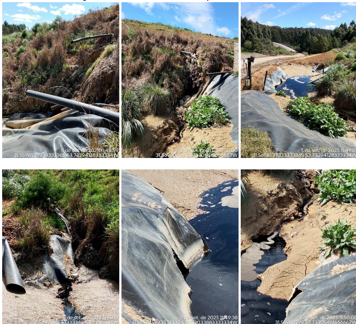
Figura 10: Ponto de acúmulo de lixiviado proveniente da célula 01
