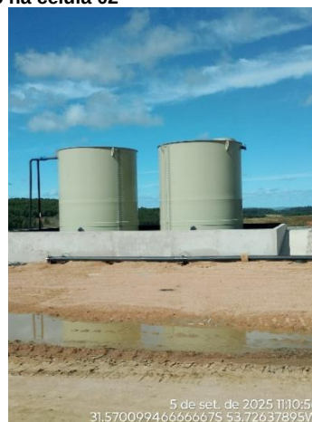
Figura 16: Tanques para o armazenamento de lixiviado produzido na célula 02
