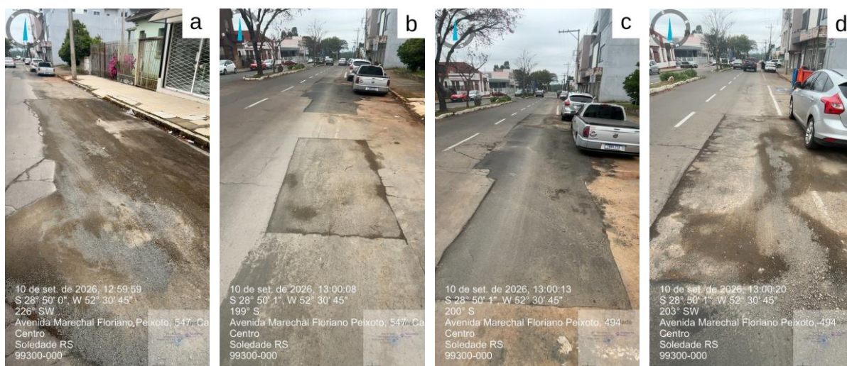
Figura 5. Irregularidades na recomposição da pavimentação na Av. Marechal Floriano Peixoto, entre os nº 547 e 494, bairro Centro.
