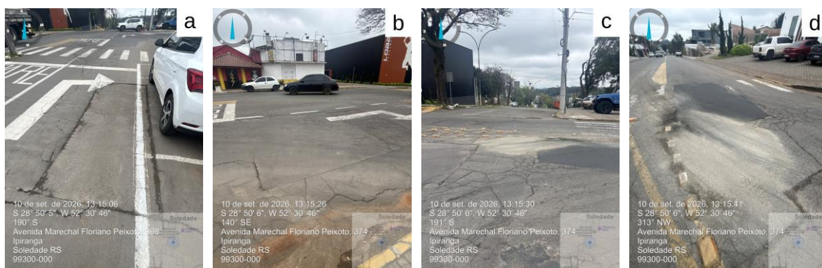
Figura 7. Irregularidades na recomposição da pavimentação na Av. Marechal Floriano Peixoto, próximo ao nº 374, bairro Centro.
