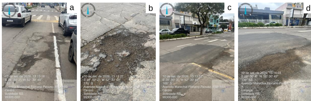
Figura 6. Irregularidades na recomposição da pavimentação na Av. Marechal Floriano Peixoto, entre os nº 456 e 414, bairro Centro.
