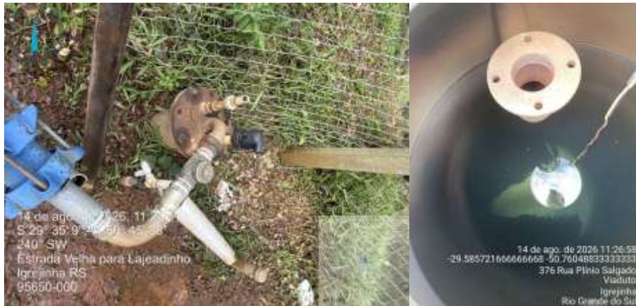
Figura 3: estação elevatória EBA 3 (à esquerda) e vista interna do Reservatório R3, em 14 de agosto de 2026
