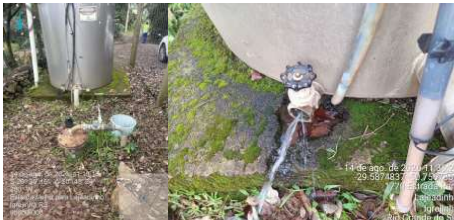
Figura 4: Reservatório R4 e estação elevatória EBA 4 (à esquerda) e descarga de água pelo registro instalado junto à base da unidade (à direita), em 14 de agosto de 2026
