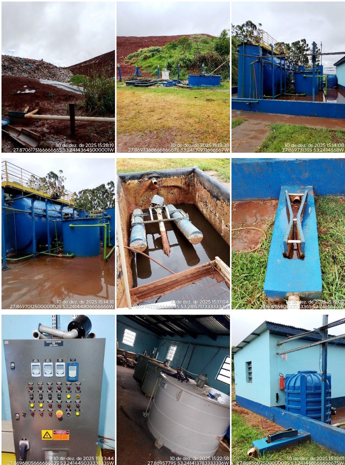
Figura 6: ETE desativada existente no aterro sanitário
