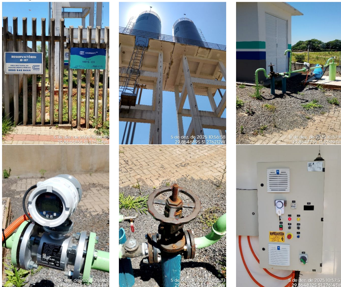
Figura 05: Ativos localizados na unidade do SAA da rua Araucária, nº 29 - Loteamento Residencial Porto das Pedras.
