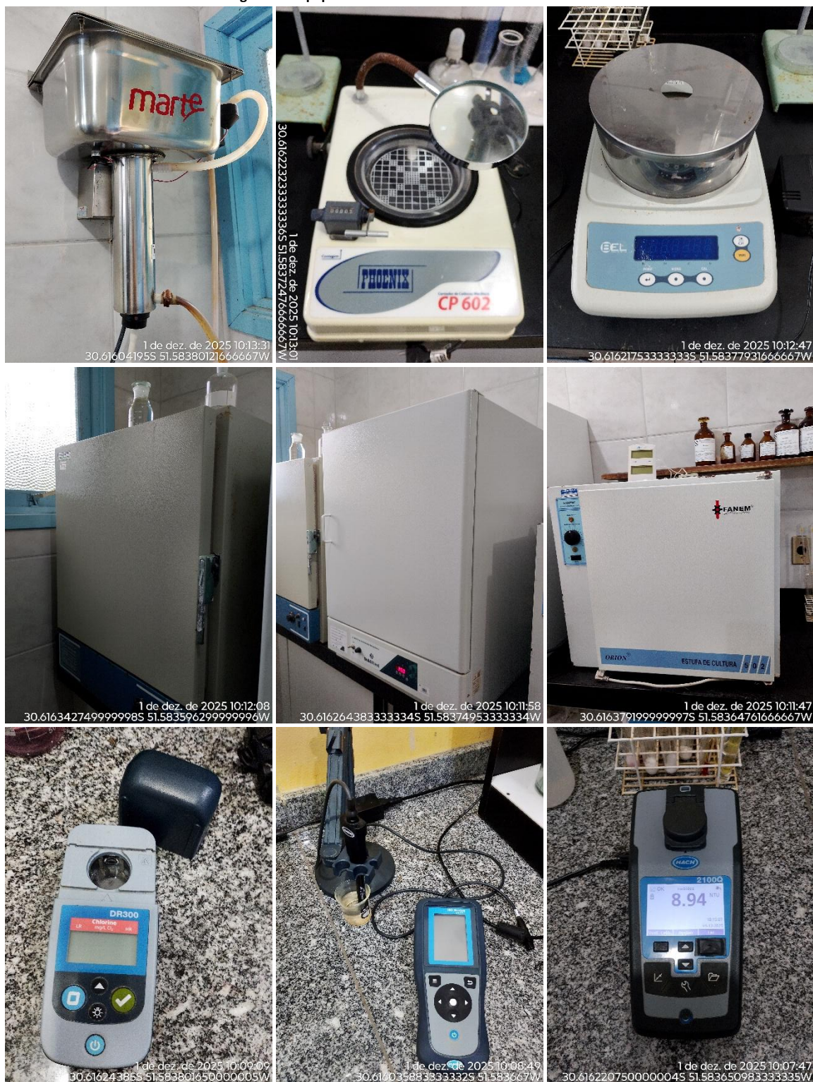
Figura 02: Equipamentos de laboratório existentes na ETA
