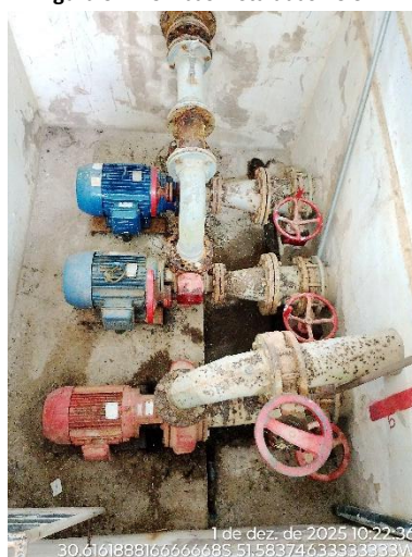
Figura 01: Bombas instaladas no SAA
