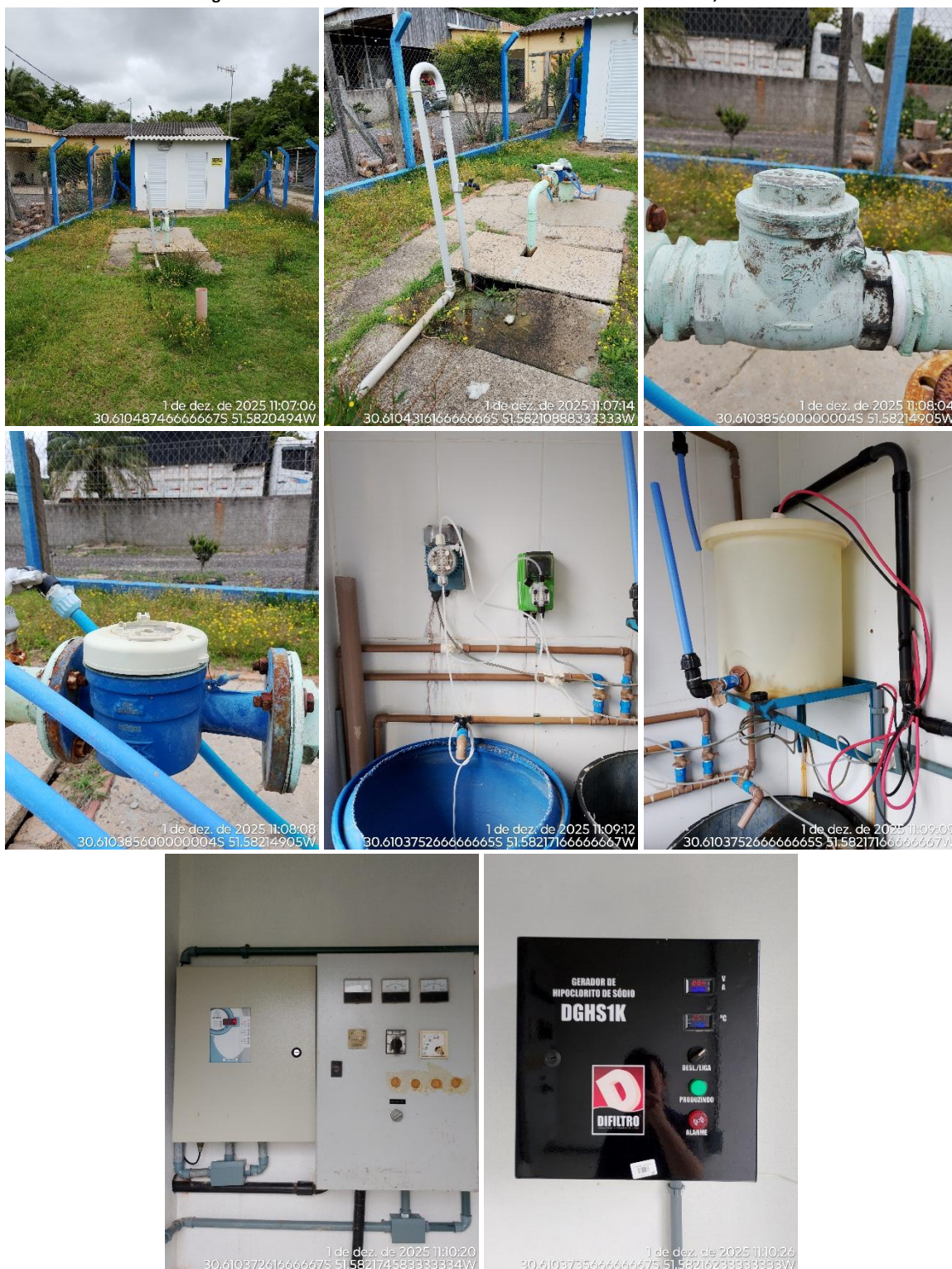
Figura 06: Ativos existentes na unidade da Rua Manoel Batista Gomes, n. 60.
