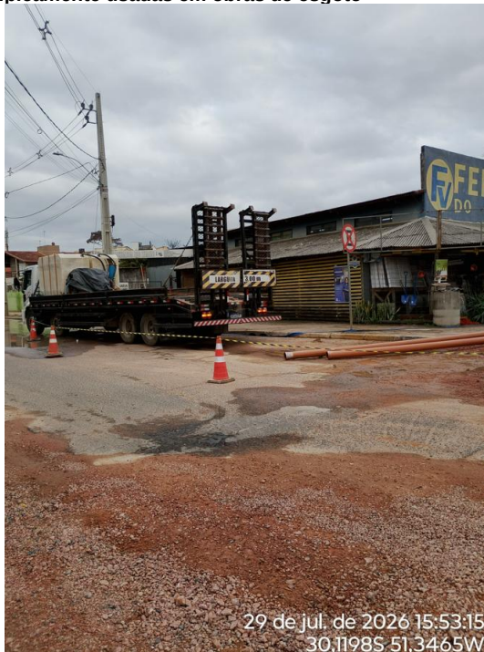
Figura 4 - Evidências da manipulação de tubulações tipicamente usadas em obras de esgoto
