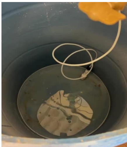
Figura 1. Bombona de dosagem sem produto químico na unidade Poço SJR-05, em 16 de julho de 2026 (Fonte: Vigilância Sanitária).
