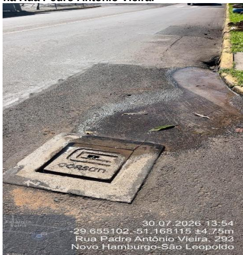
Figura 3. Local do extravasamento no ponto 3 na Rua Pedro Antônio Vieira.
