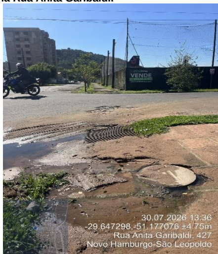
Figura 1. Local do extravasamento no ponto 1 na Rua Anita Garibaldi.
