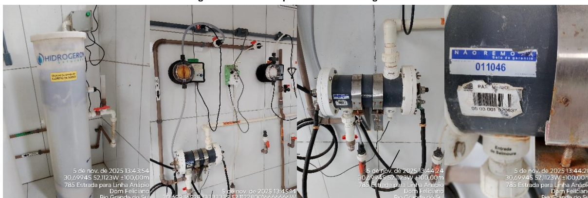
Figura 08: Gerador Hipoclorito Sódio 3-4 Kg – ETA
