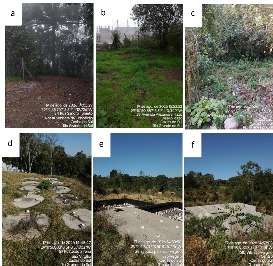
Figura 01: identificação de evidências das SLTE. a) SLTE Danilo Betiato; b) SLTE Centro Empresarial Oeste; c) SLTE Colina do Lago III; d) SLTE Parque Bela Vista I; e) SLTE Parque Bela Vista II e f) SLTE Parque Bela Vista III.
