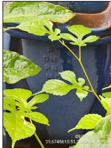
Figura 32: Tubulação na caixa de manobras do Reservatório R-1A.
