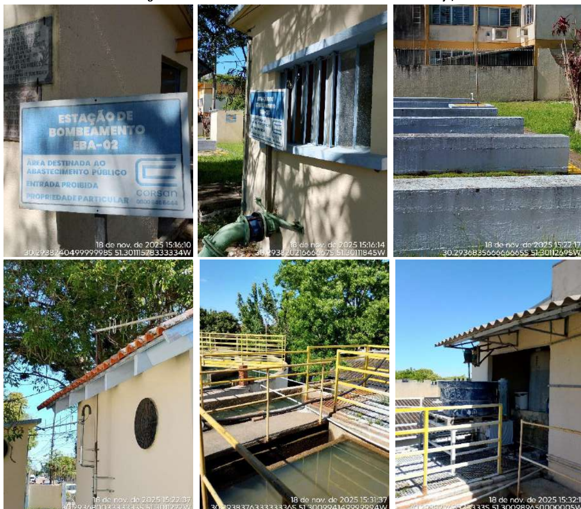
Figura 04: Ativos localizados na unidade do SAA da rua Coronel Araújo,410.
