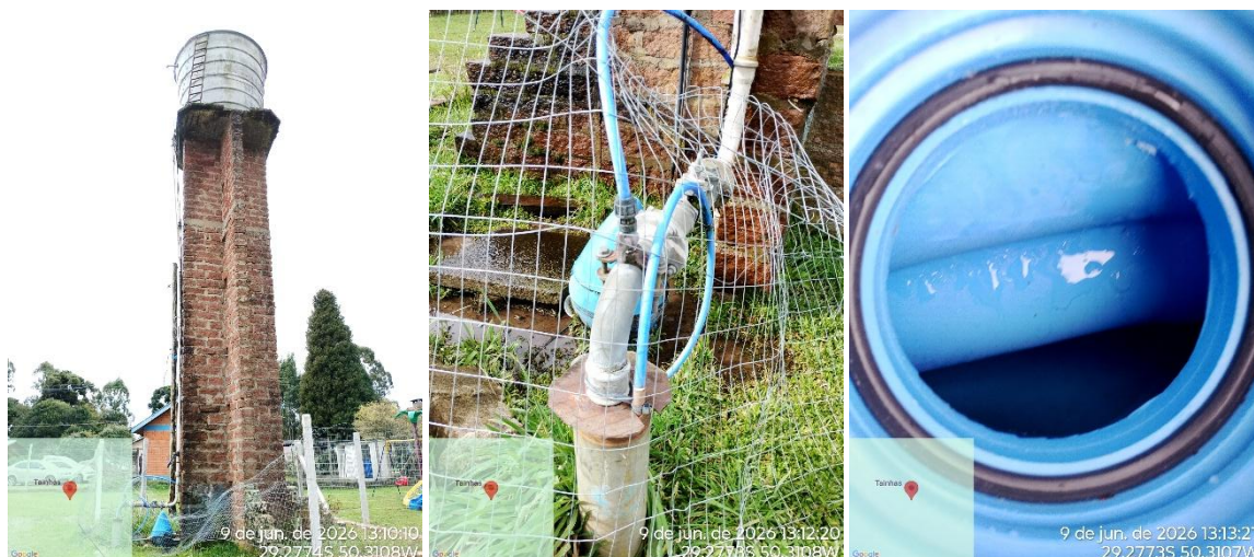
Figura 2 - Registro fotográfico ausência de pastilhas de cloro.
