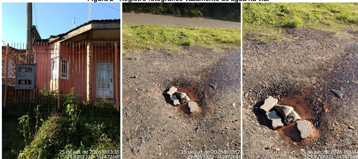
Figura 2 - Registro fotográfico vazamento de água na via.
