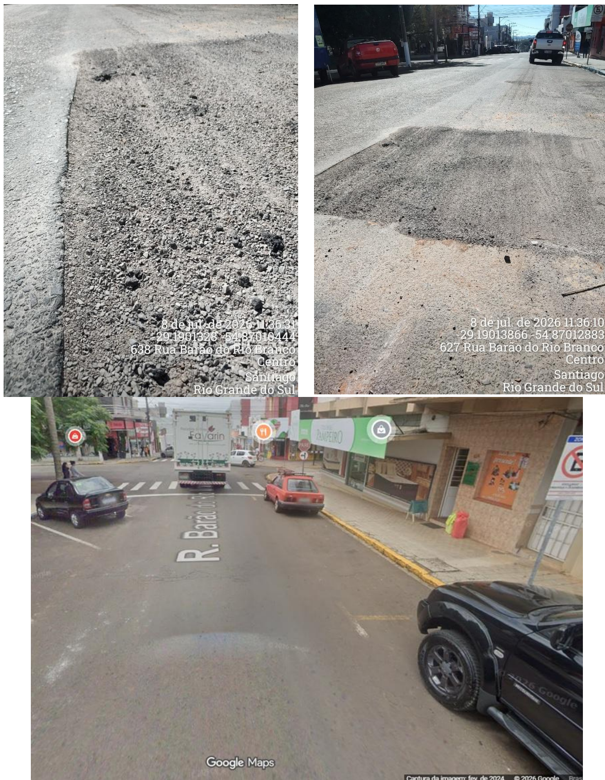
Figura 11 – Registros fotográficos do Ponto 5 da Rua Barão do Rio Branco. Erosão e desgaste da via por má pavimentação e comparação com imagem do Google StreetView datada de fev/2024.
