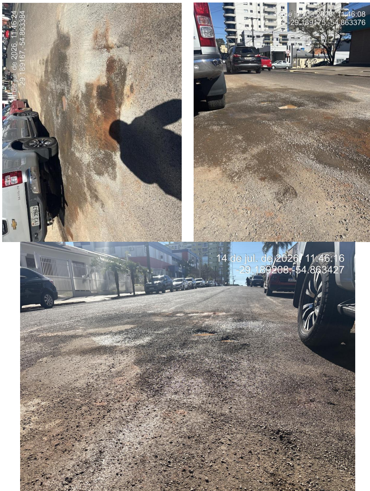
Figura 21 – Registros fotográficos do Ponto 10 da Rua Pinheiro Machado. Deformação na pavimentação após retirada do pavimento e recomposição inadequada. A presença de buracos com acúmulo de água.
