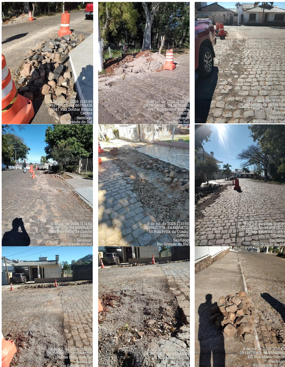
Figura 19 – Registros fotográficos do Ponto 9 da Rua Mário Garcia. Deformação na pavimentação após retirada do pavimento e recomposição inadequada. Destaca-se material depositado próximo ao meio fio.
