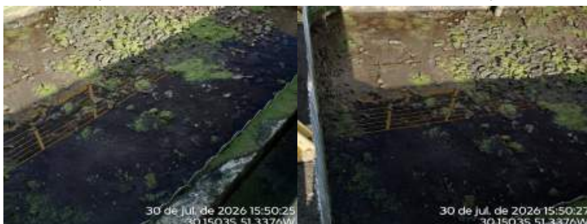
Figura 5 – Reator UASB da ETE Nossa Senhora do Livramento com acúmulo de água
