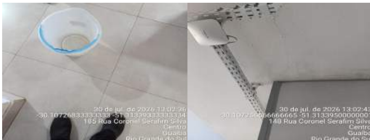
Figura 7 – Balde coletando água de goteiras (esquerda) e goteiras no teto (direita)
