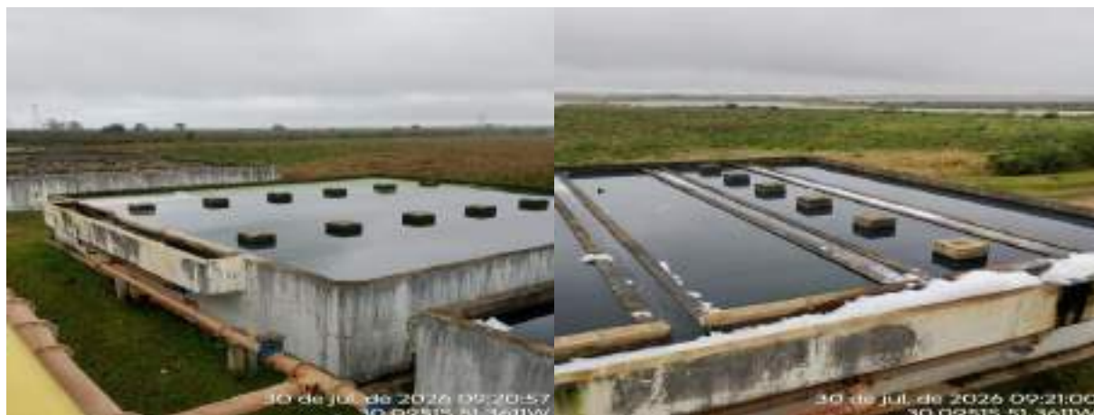
Figura 6 – Filtros biológicos percoladores operando afogados
