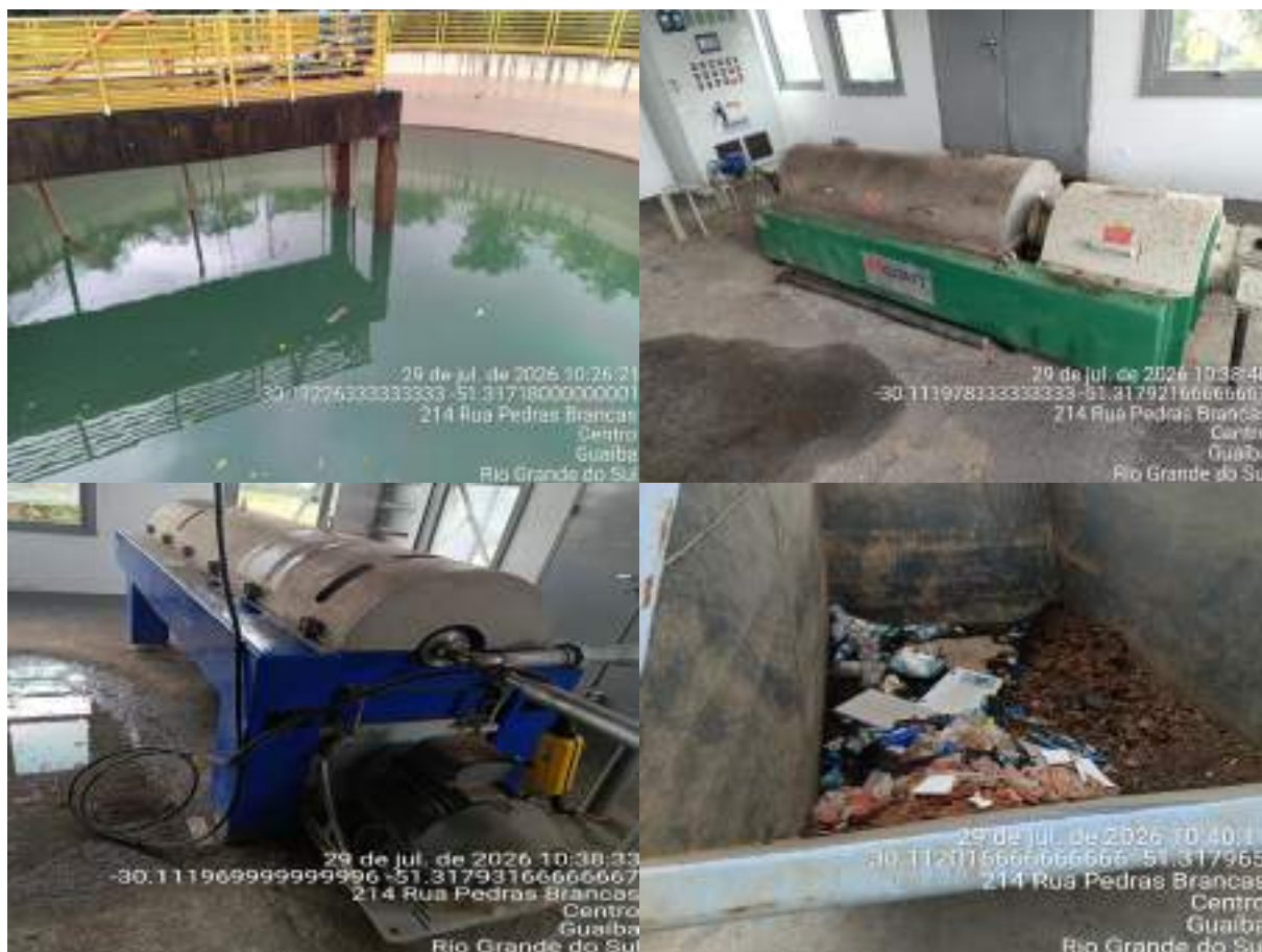
Figura 1 - Sistema de secagem de lodo inoperante (tanque de lodo cheio, centrífugas paradas e caçamba com resíduos outros que não o lodo após secagem)
