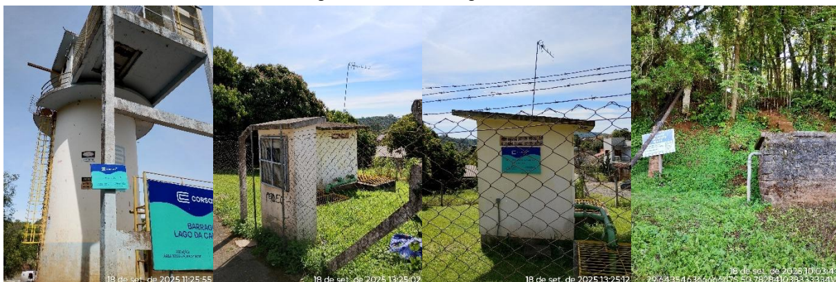
Figura 01: Elevatórias de água do SAA
