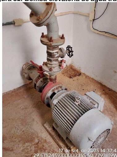
Figura 31: Bomba elevatória de água tratada
