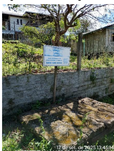
Figura 8: Elevatória de água tratada
