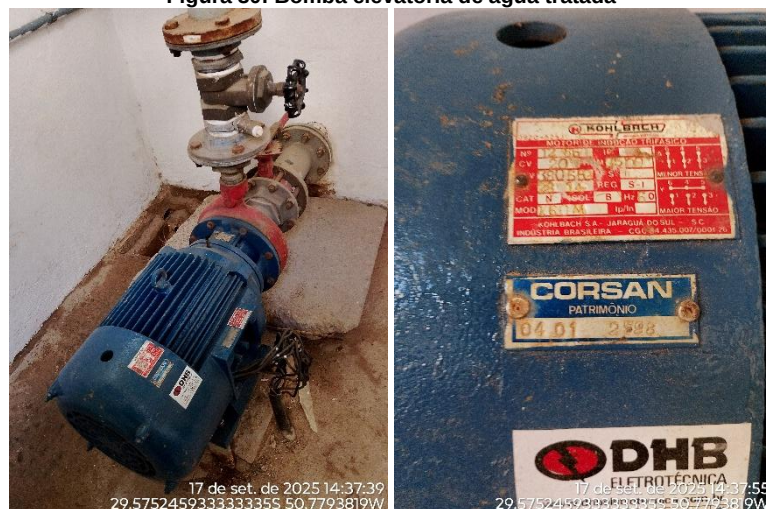
Figura 30: Bomba elevatória de água tratada
