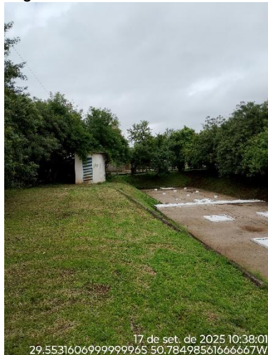
Figura 7: Estação de Tratamento de Esgoto
