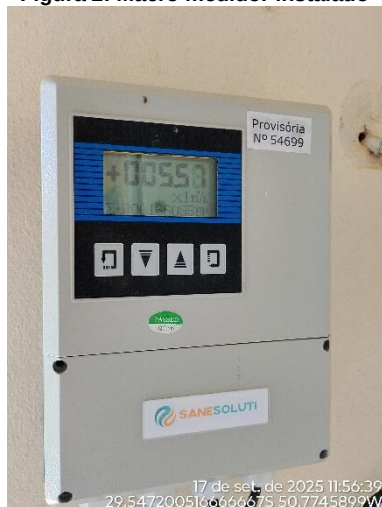
Figura 2: Macro medidor instalado
