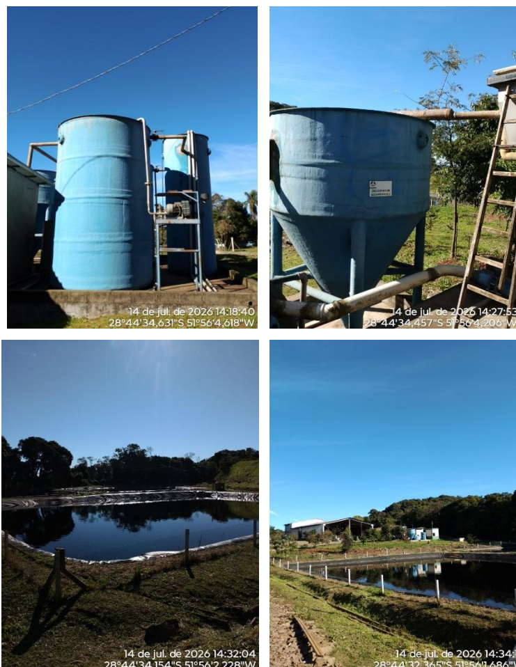
Figura 11: Estação de Tratamento de Efluentes.
