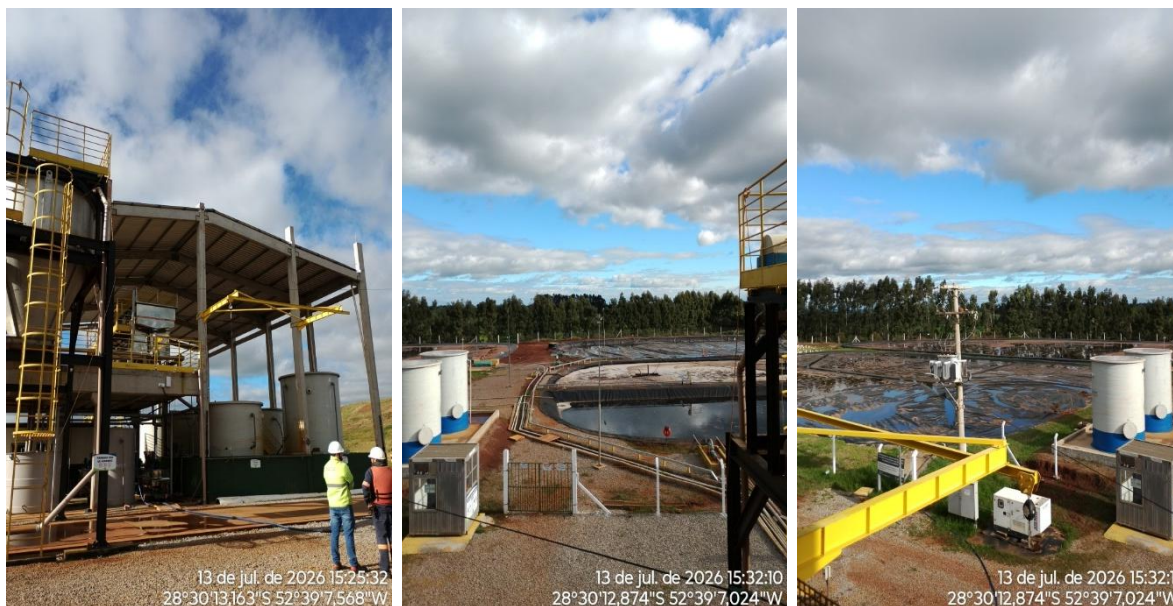
Figura 06: Visão geral da Estação de Tratamento de Efluentes (ETE).
