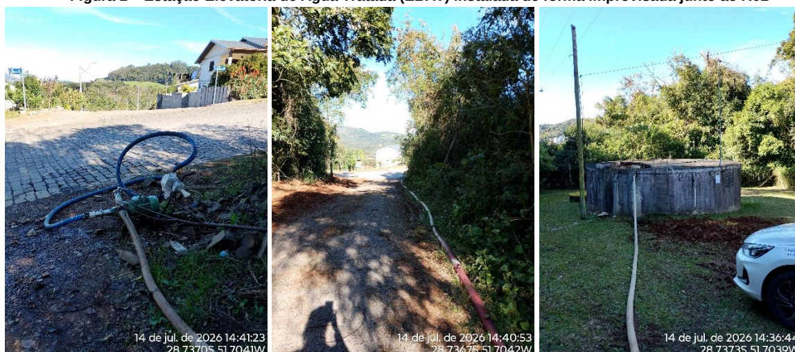
Figura 1 – Estação Elevatória de Água Tratada (EBAT) instalada de forma improvisada junto ao R01
