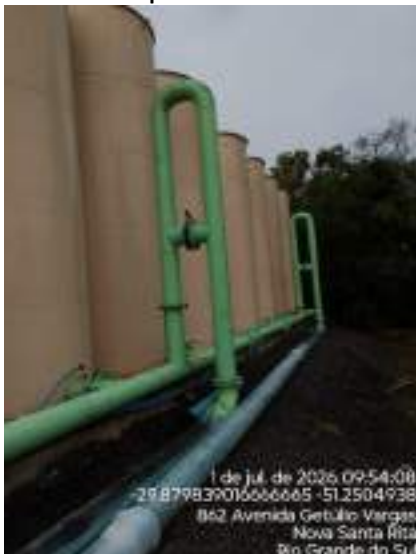
Figura 7 – ETA Compacta Nova Santa Rita.
