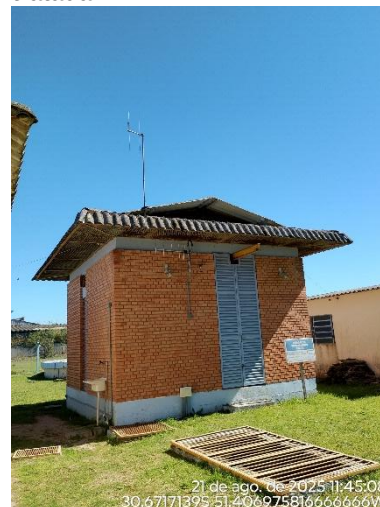
Figura 9: Elevatória de água tratada
