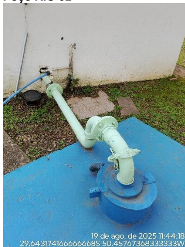
Figura 20: Captação subterrânea Poço RIO 02
