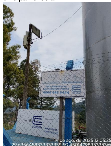
Figura 9: Sistema de telemetria R 01 e painel solar
