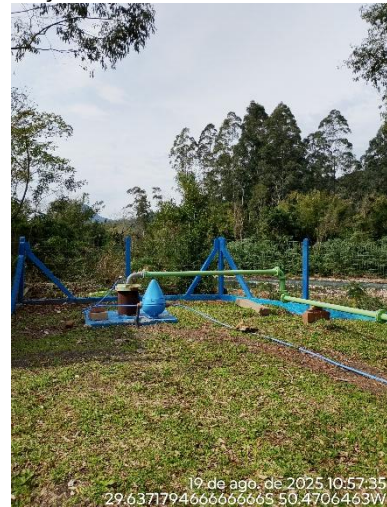
Figura 19: Captação subterrânea Poço RIO 06
