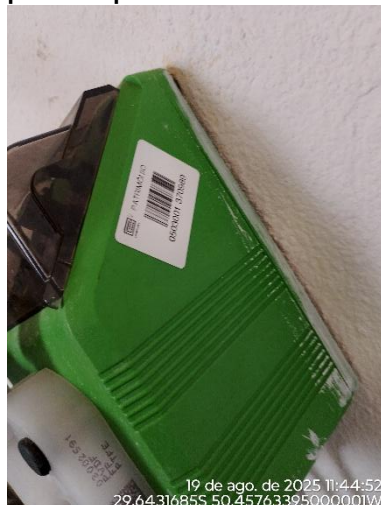
Figura 23: Bomba dosadora de produto químico 2
