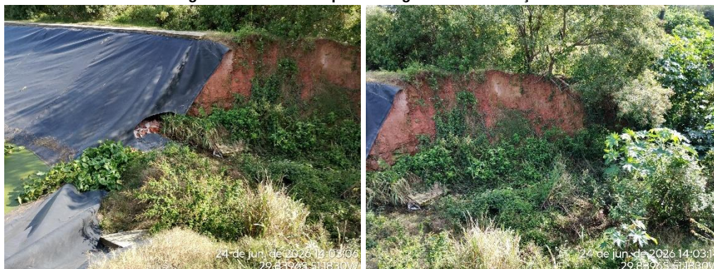
Figura 5 – Talude rompido na lagoa de estabilização.
