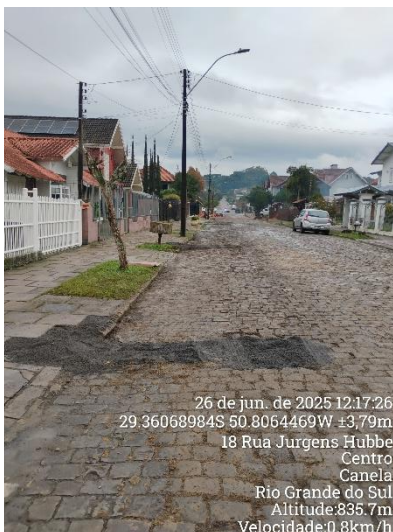
Ponto 02 – intervenções em ramais sem sinalização.
