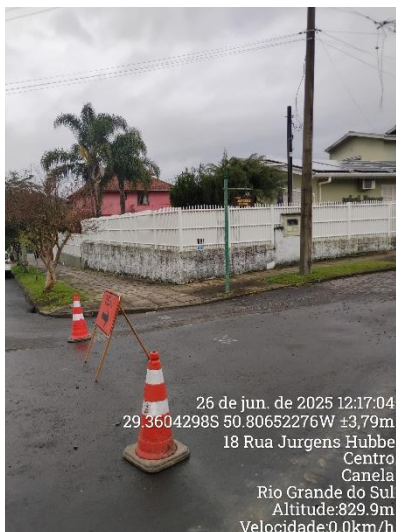
Ponto 02 – ausência de sinalização de obra da Corsan.
