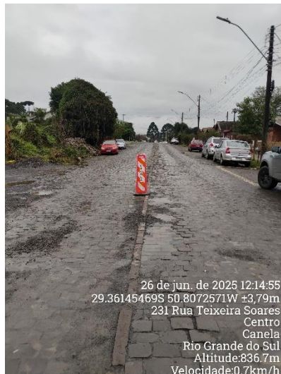
Ponto 01 – deformações na via após intervenções.
