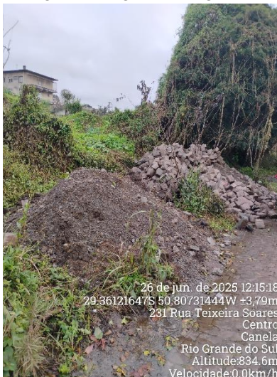
Ponto 01 – acúmulo de materiais após intervenção sem identificação.
