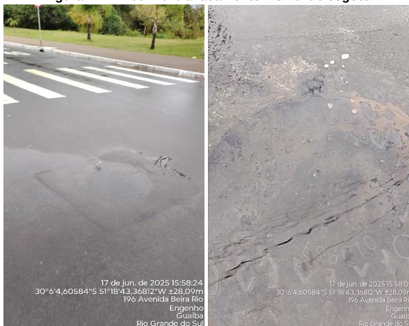
Figura 2 – PV com extravasamento visível de esgoto.
