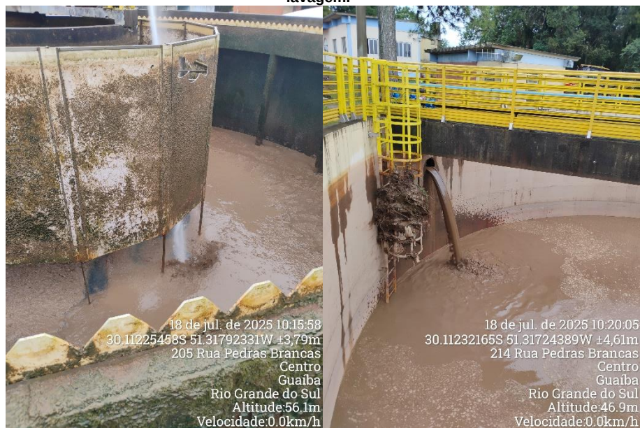
Figura 6 – Decantador da ETA I em procedimento de lavagem, e tanque de acúmulo de lodo recebendo águas de lavagem.
