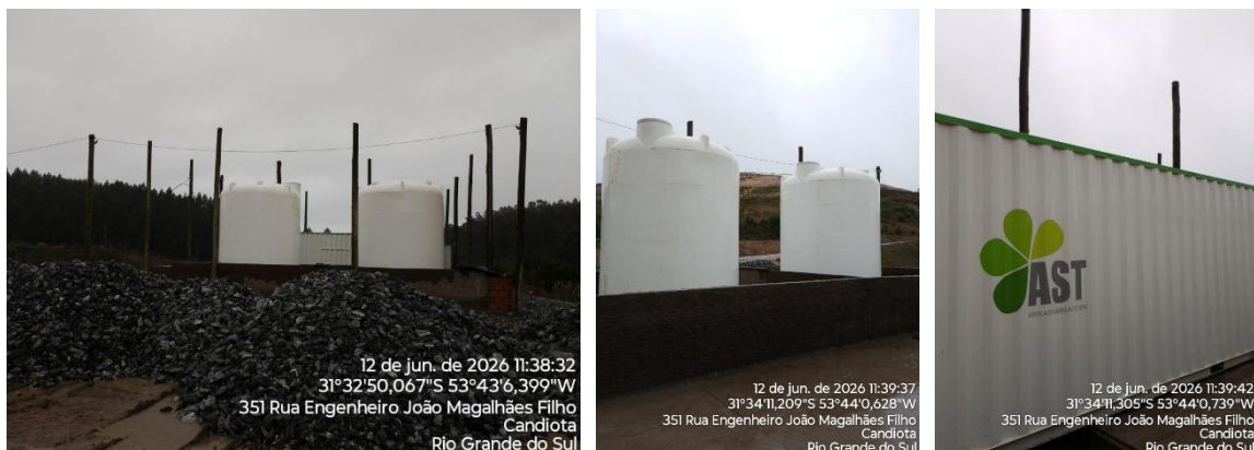
Figura 09: Tratamento de lixiviado via processo físico-químico
