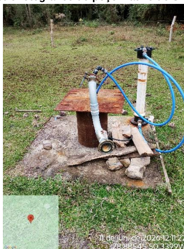
Figura 2: Registro fotográfico do poço inativo do SAA de Jaquirana.
