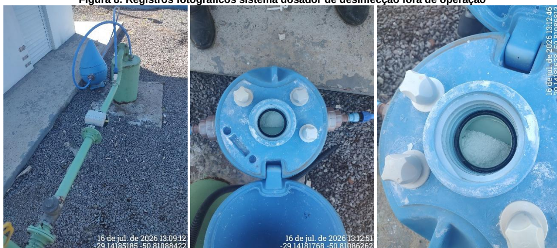
Figura 8: Registros fotográficos sistema dosador de desinfecção fora de operação
