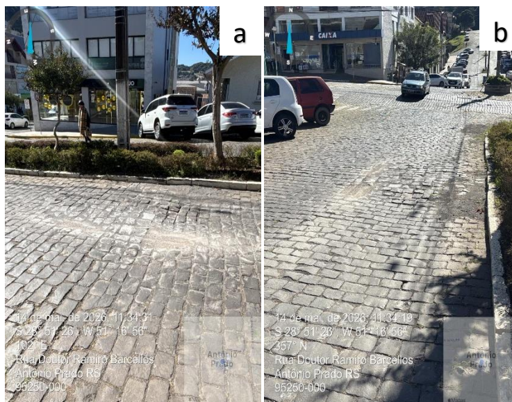
Figura 2. Irregularidades na recomposição da pavimentação na Rua Waldemar Mansueto Graziotin, bairro Centro.
