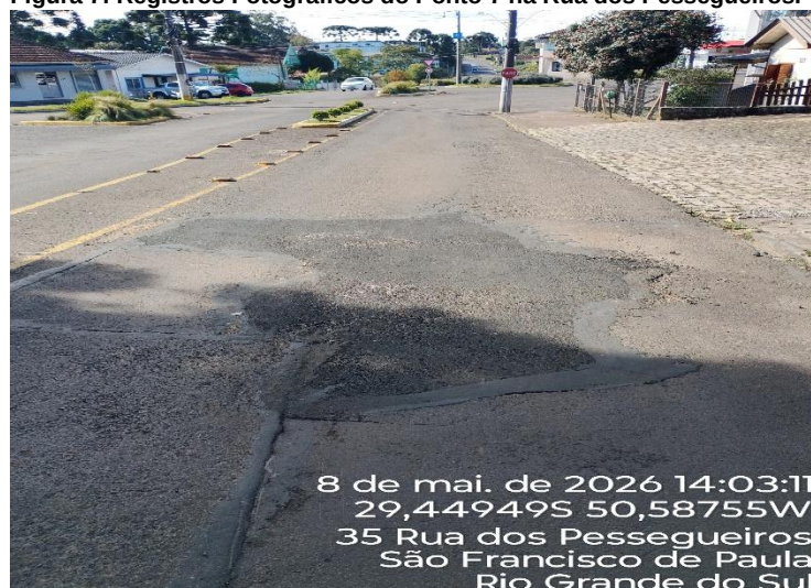
Figura 7: Registros Fotográficos do Ponto 7 na Rua dos Pessegueiros.
