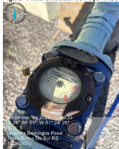
Figura 4. Macromedidor do Poço NRS06
