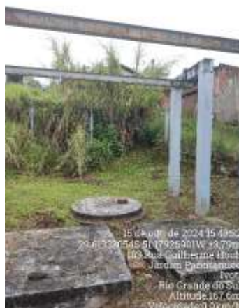
Figura 4 – Estrutura da EBE do SES.
