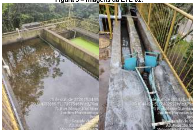
Figura 5 – Imagens da ETE 01.
