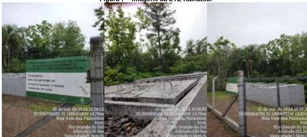
Figura 7 – Imagens da ETE Kaihatsu.
