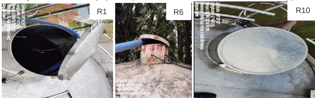
Figura 3 – Reservatórios preparados para receber abastecimento por meio de caminhão pipa.
